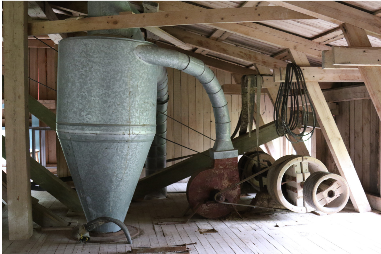
Pöyliön myllyn puhdistuslaitteistoa voimavälityksineen myllyrakennuksen ylimmässä kerroksessa.
