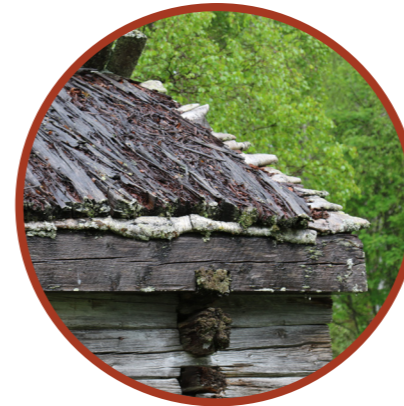
Tuomiojan myllyn tuohi-malkakattorakenne on korjauksen tarpeessa
