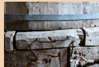
Soppanan myllyn kahassa oleva jauhojen tarkistusluukku.
