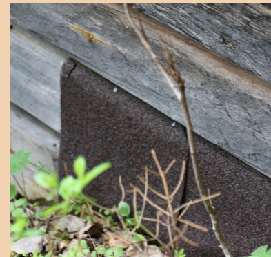
Kampsajoen myllly hirsiseinän alaosaan on naulattu palahuopaa.
