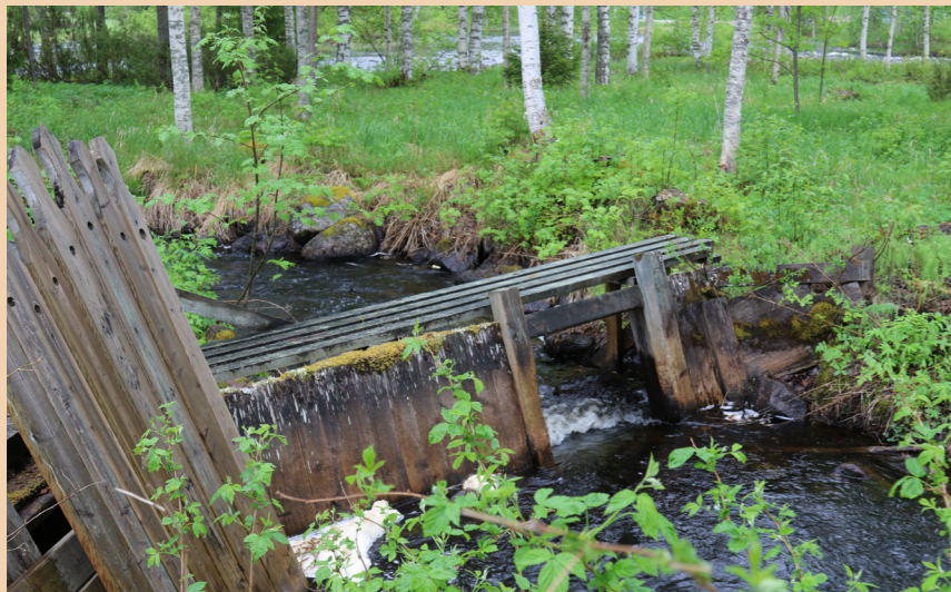
Uulan myllylle johdettiin vesi Sinettäjoesta lähtevää sivu-uomaa pitkin, joka vaatimattomasta koostaan huolimatta mahdollisti myllylle ympärivuotisen käytön.
