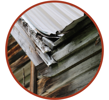
Soppanan myllyn kattorakenne, jossa alla huonokuntoinen pärekatto ja päällä pelti
