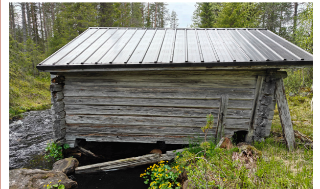
Posiolla sijaitseva Kylmäniemen mylly on myllyrakennuksista huonoimmassa kunnossa ja jo osittain romahtanut veteen. Kuva: Reima Revonmäki, 2025.
